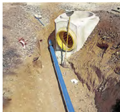
Auch bei der Erneuerung des Abwasser-schachts in der Teichstraße in Westeregeln 2024 war Tiefbau nötig. Fotos (2): WAZV „Bode-Wipper“
