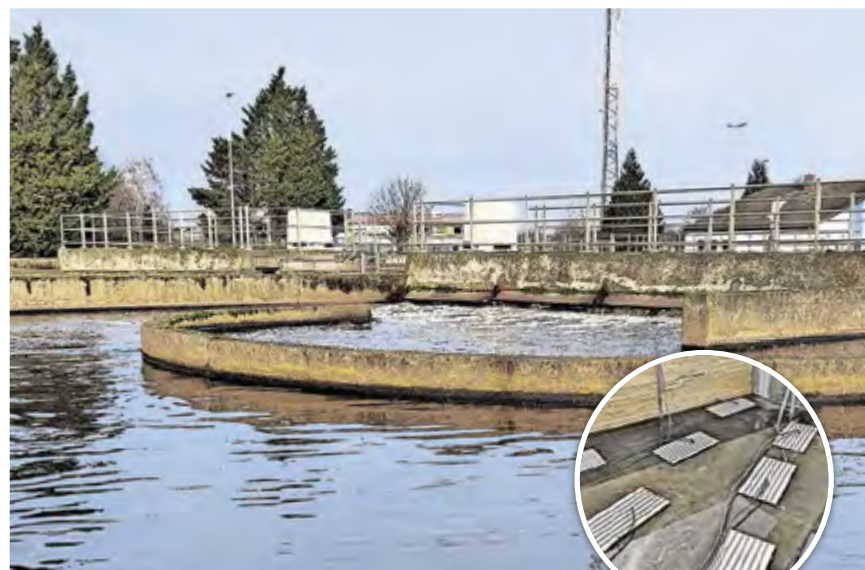
Effizienter und stromsparend: Neue Belüfterplatten sollen den Energieverbrauch im Belebungsbecken reduzieren.
